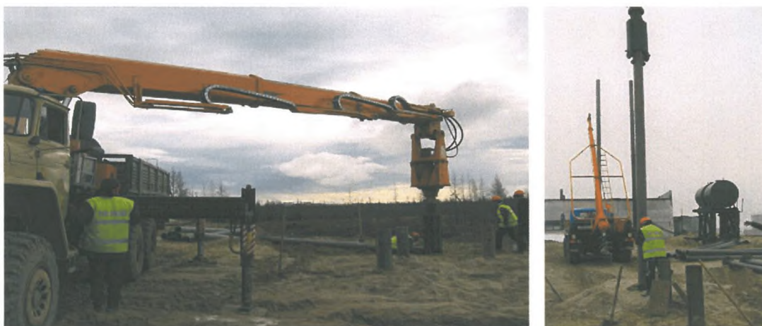
Рис.2.5 - Строповка-захват головы сваи патроном, подъем, перемещение и вертикальное погружение свай в скважину-котлован
