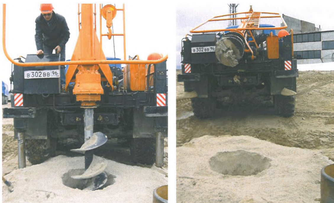
Рис. 2.3 - Бурение скважины (котлована) буром со шнеком диаметром 500 мм в сезонно-мёрзлых песчаных грунтах на глубину до 5,0 м (БКМ-515); светлые объёмы – мерзлый разбуренный песчаный грунт
