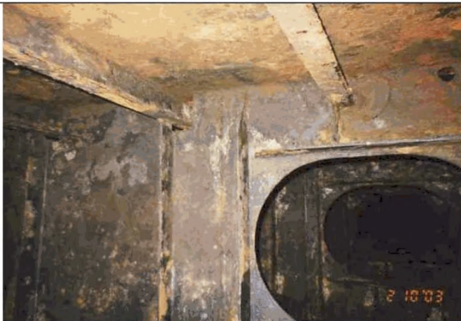
ПЛОХОЕ СОСТОЯНИЕ ПОКРЫТИЯ
