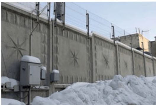
Рисунок 2.3 – Внешний вид емкостного СО, установленного на железобетонном заборе
