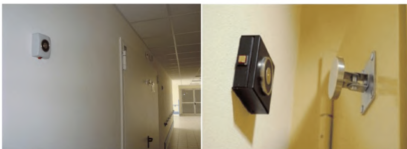
Рисунок 111 – Автоматические устройства фиксации дверей, срабатывающие при пожаре
