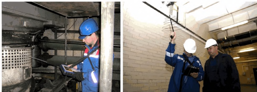
Рисунок Е.1- Локация электрических разрядов в токопроводе с использованием различных сканеров радиочастоты и направленной антенны
