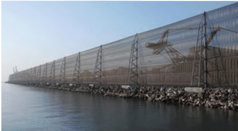
Рисунок 107 – Ветрозащитный экран парусного типа установлен в угольном терминале
