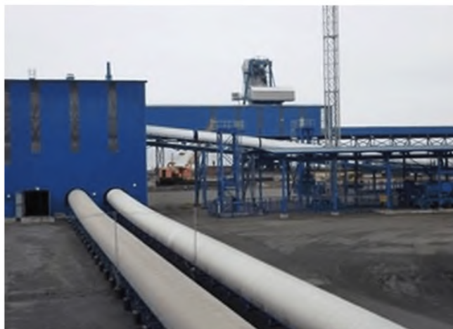
Рисунок 55 – ТКС с полностью закрытыми конвейерами
