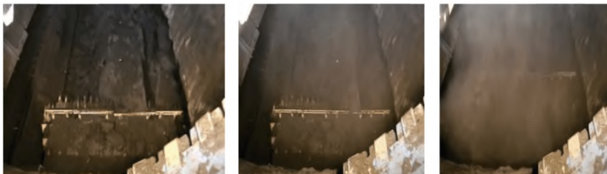
Рисунок 50 – Фазы работы дробильно-фрезерной машины. Организованный источник пыления
