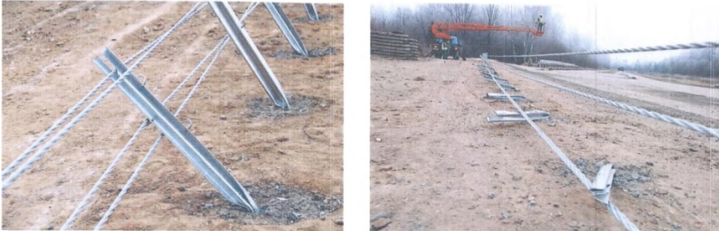
Рисунок 6 – Деформация открытых стоек
