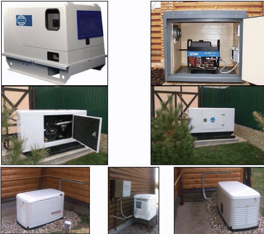
Рисунок 23. Примеры размещения электрических генераторов в контейнерах.
