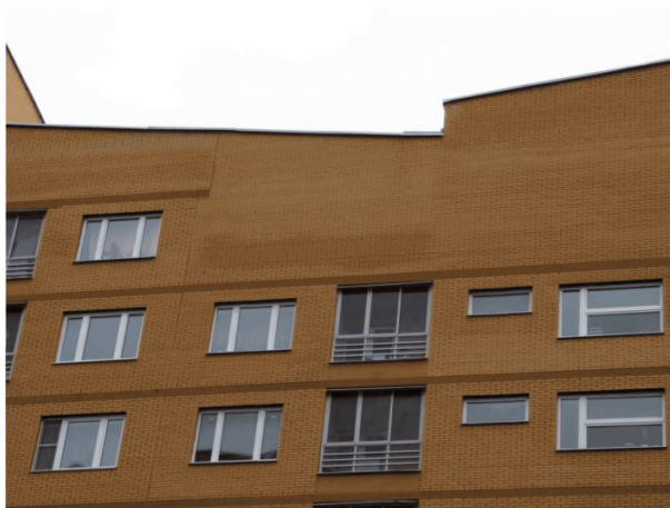
Рисунок А.5 – Увлажнения кладки из кирпича парапетов здания при соприкосновении кладки со снеговыми мешками
