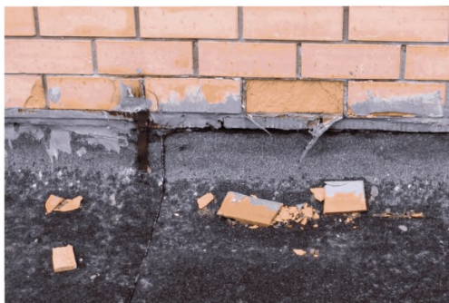
Рисунок А.3 – Разрушения поверхности облицовочных изделий при воздействии атмосферных осадков снаружи конструкции
