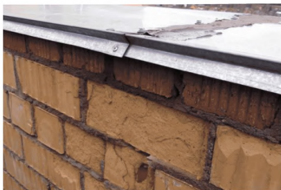
Рисунок А.4 – Разрушения облицовочного слоя вследствие проникновения воды в толщу конструкции при нарушениях окрытия
