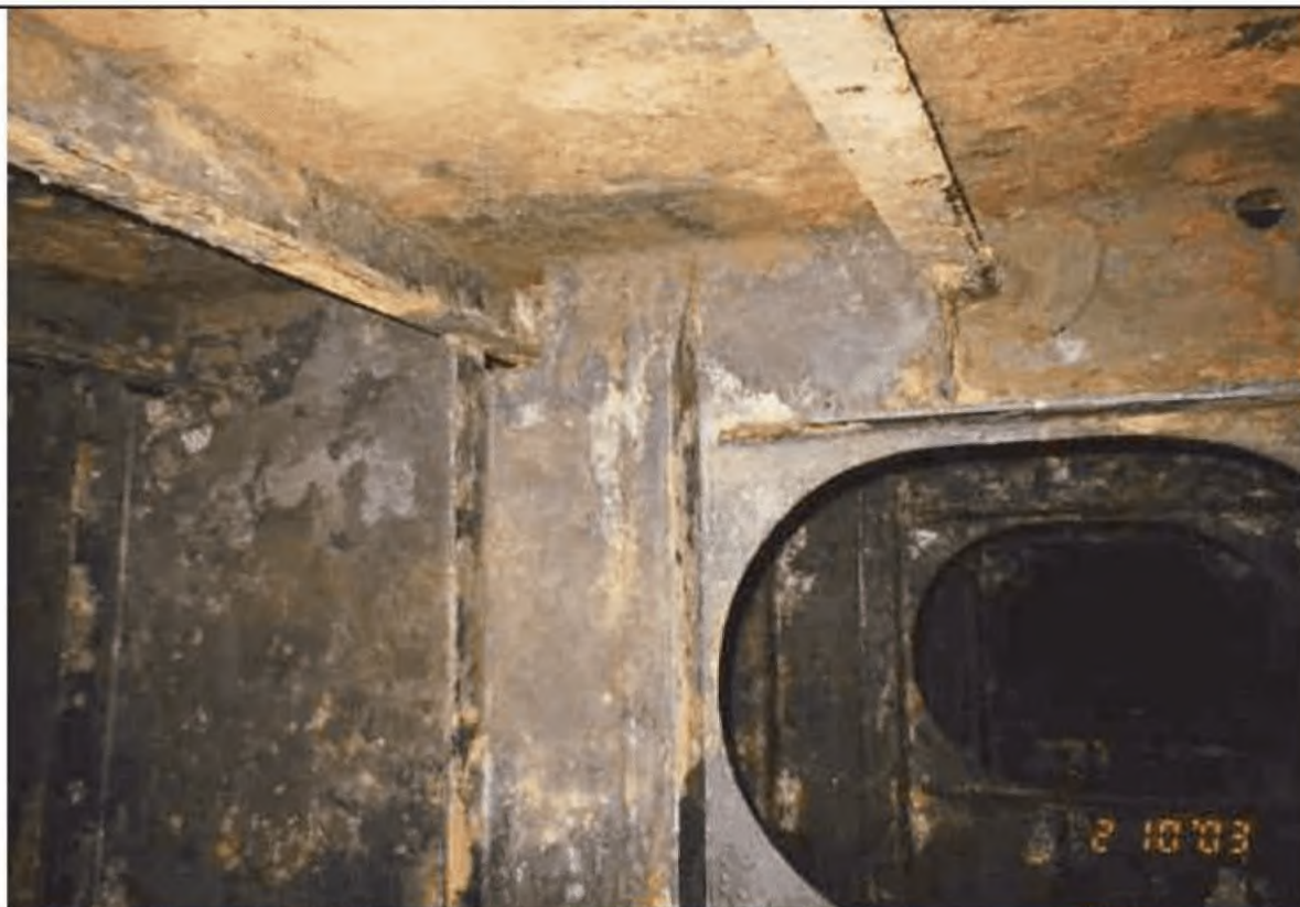
ПЛОХОЕ СОСТОЯНИЕ ПОКРЫТИЯ
