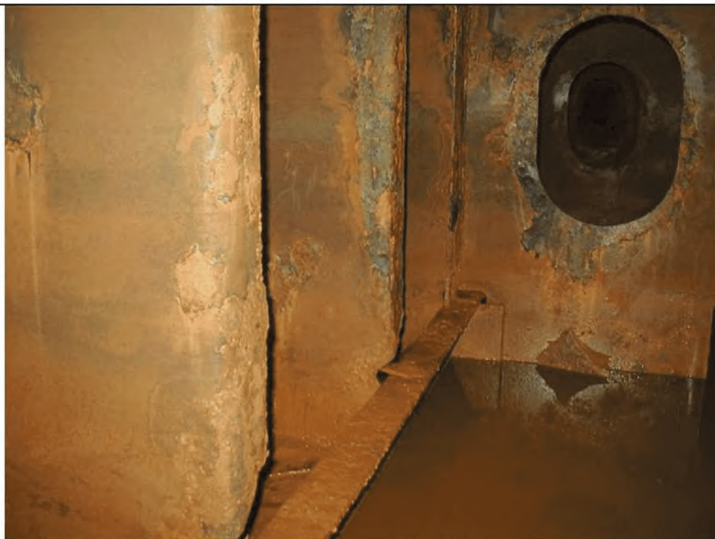
ПЛОХОЕ СОСТОЯНИЕ ПОКРЫТИЯ
