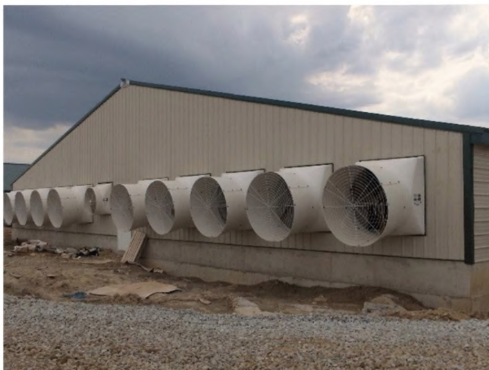
Рисунок 2.18 — Внешний вид здания с вытяжными вентиляторами
