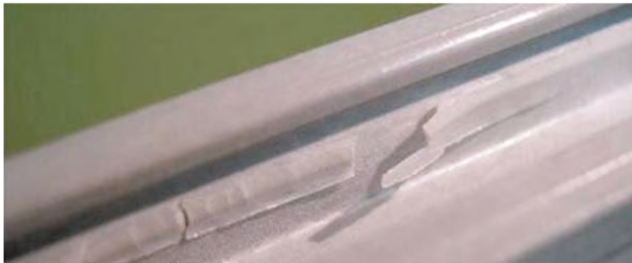
Рисунок А.33 — Отслоение
