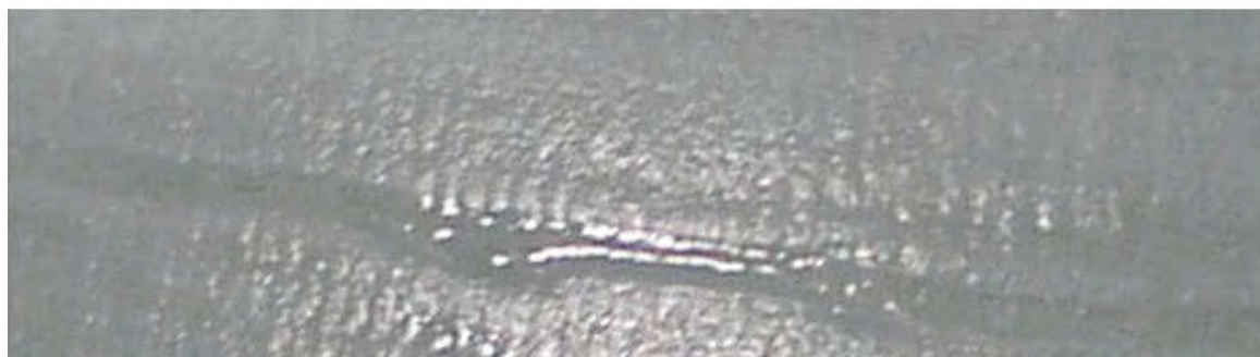
Рисунок А.26 — Избыток отвержденной смолы
