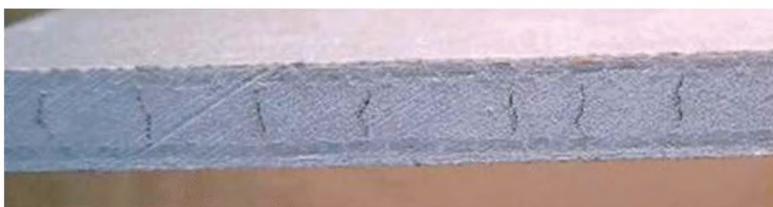
Рисунок А.21 — Внутренние усадочные трещины
