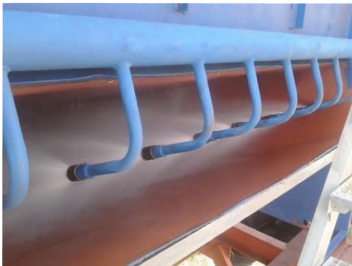
Рисунок 2.15 — Коллектор циркуляционной воды с форсунками эжекционной градирни 3)
