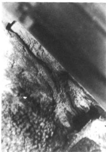
Рис. 4. Повреждения наружных поверхностей каменных зданий и сооружений (отколы, осыпание, ямчатость, коррозия кладки, морщинистость, отслаивание)
