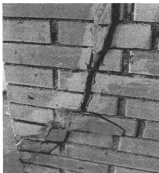
Рис. 2 — Выпучивание кладки лицевого слоя на углу стены на высоте 4-го этажа
