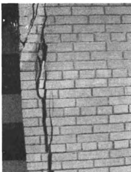
Рис. 1 — Вертикальная трещина на углу стены между 3-м и 4-м этажами
