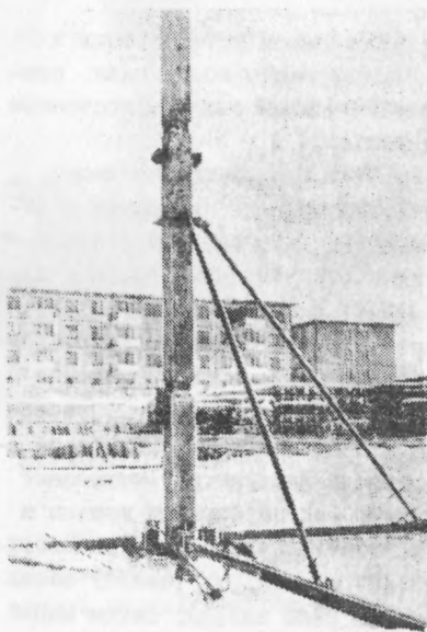
Рис. 12. Комплект оснащения для монтажа каркаса с многоэтажными колоннами сечением 300x300 мм, устанавливаемыми в стаканы фундаментов
