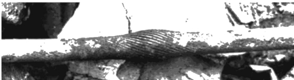
Рисунок А.13 — Дефект несущего каната закрытой конструкции — местное увеличение диаметра каната
