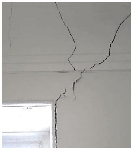
Рисунок 1 – Пример кладки с отдельными деформационными трещинами, проходящими по проему в стене и возникшими вследствие неравномерной осадки фундаментов
