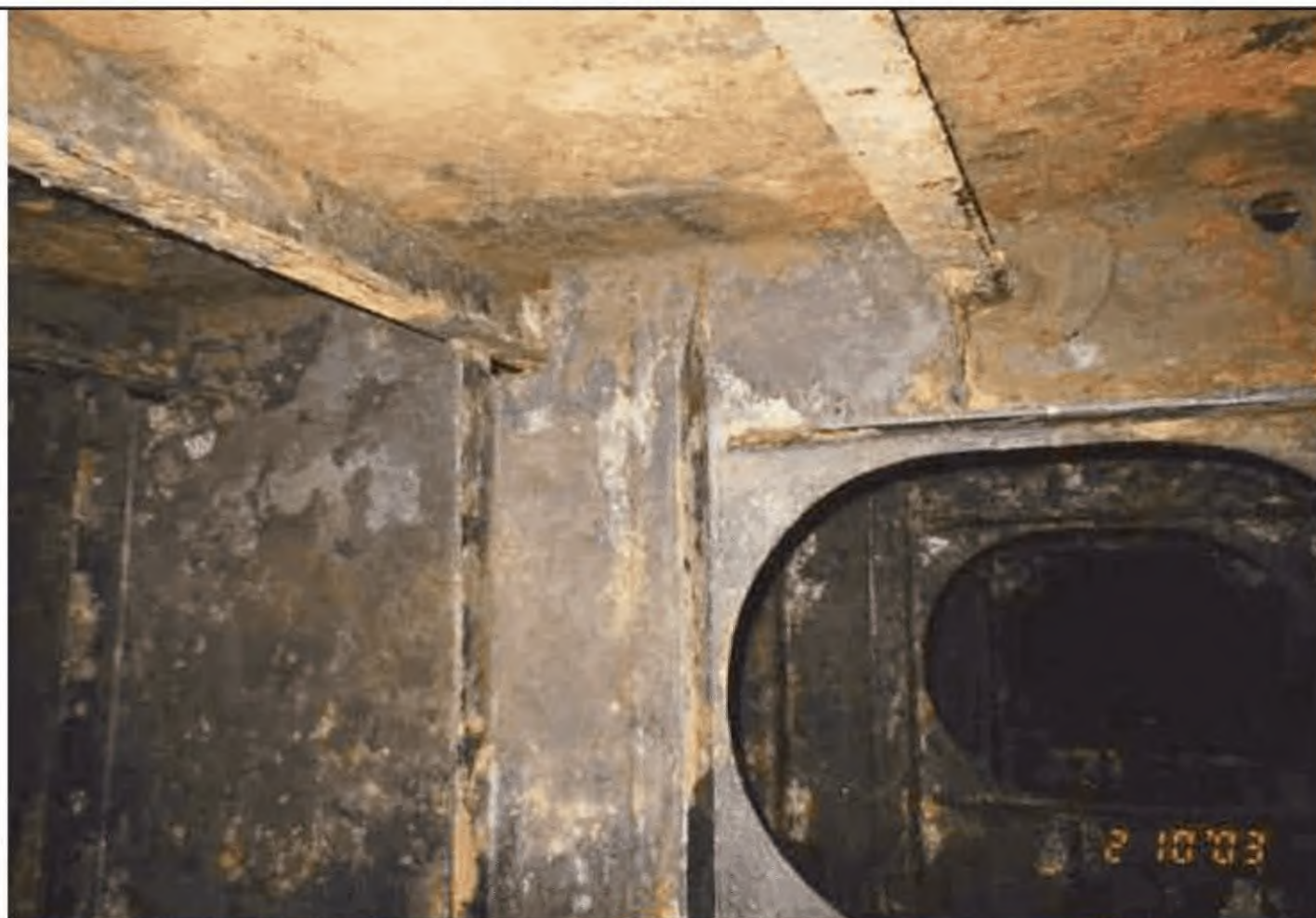
ПЛОХОЕ СОСТОЯНИЕ ПОКРЫТИЯ
