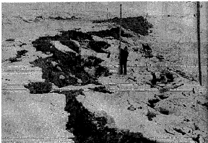
Рис.4.9. Пример обрушения откоса плотины.
